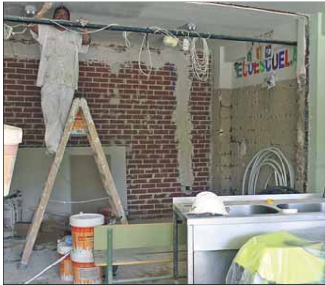
La restauración de los edificios y de sus instalaciones se viene haciendo durante las vacaciones estivales
